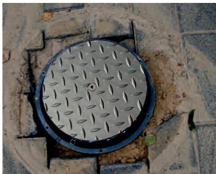
Figura 5: Pilão no chão
